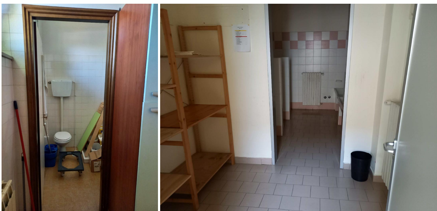
Dettaglio delle porte che necessitano un intervento di adeguamento
